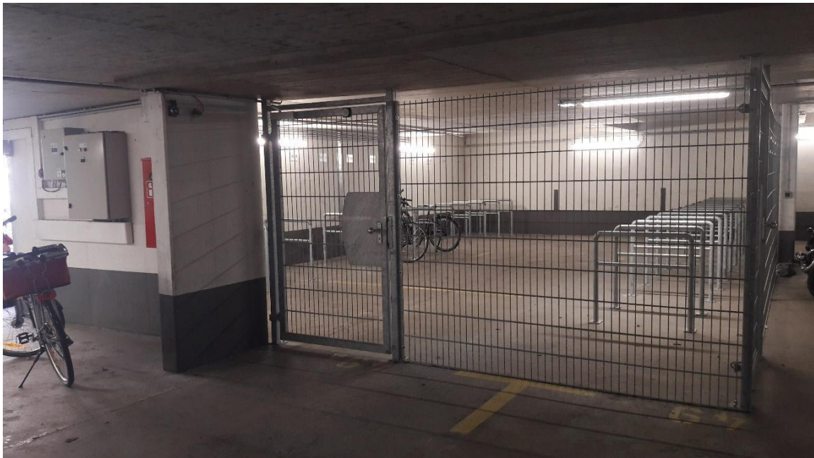
Oben: Fahrradabteil in einer Tiefgarage (Foto: BSW)
