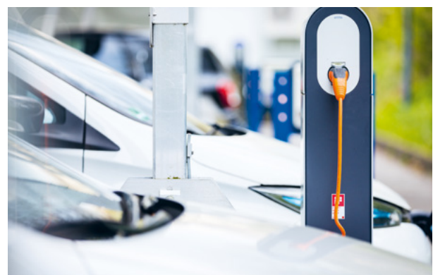
Mit dem ELBE-Zuschuss unterstützen wir die Infrastruktur für Elektrofahrzeuge.
