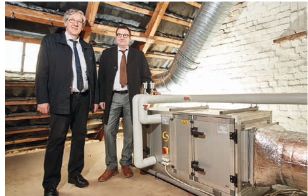
Die beiden Vorstände der Baugenossenschaft FLUWOG-NORDMARK eG, Joachim Braun und Jörg Tondt, vor dem Abluft-Wärmetauscher auf dem Dachboden der umfassend modernisierten Wohnanlage in Barmbek-Süd.
